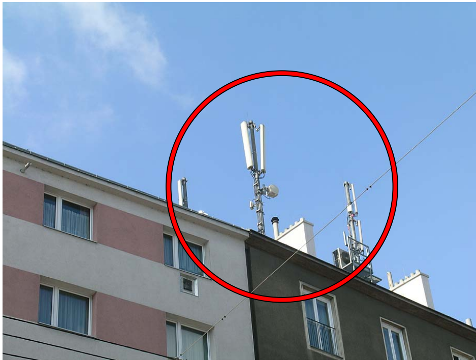
Abbildung 4.2: Mobilfunk-Basisstationen im Nahbereich einer Dachgeschoßwohnung
